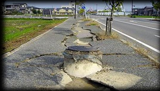
Zničený chodník po zemetrasení
